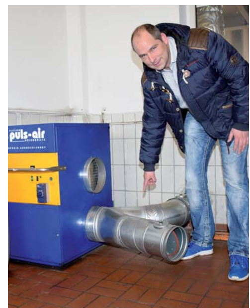
Marco Barnewold freut sich über den hohen Wirkungsgrad seiner Werkstattheizung. Ein zweites Rohr versorgt die Aufbereitungshalle mit Warmluft.
