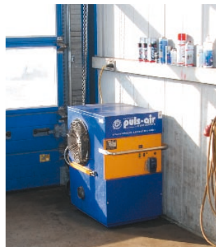
Das Pulsair-Heizgerät erwärmt die zwei Räume der Werkstatt.
